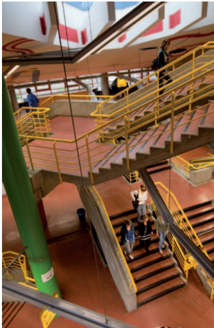
Im weitläufigen Treppenhaus beweisen ThebenHTS Präsenzmelder eine hohe Erfassungsqualität.
